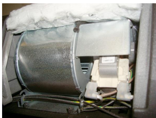
Figura n°29 - Acceso a los ventiladores
